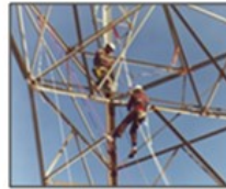
Flare / Telecom IRM
